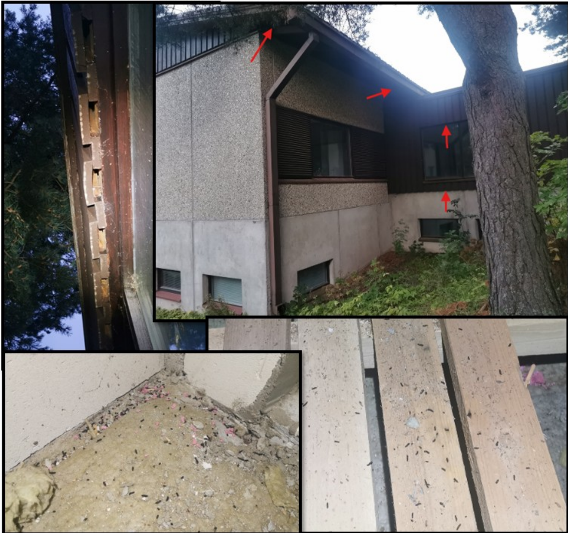
Kuva 7. Päiväpiilojen sisäänmenoreittejä 2. rakennukseen ja papanoita 2. rakennuksen vintillä.
