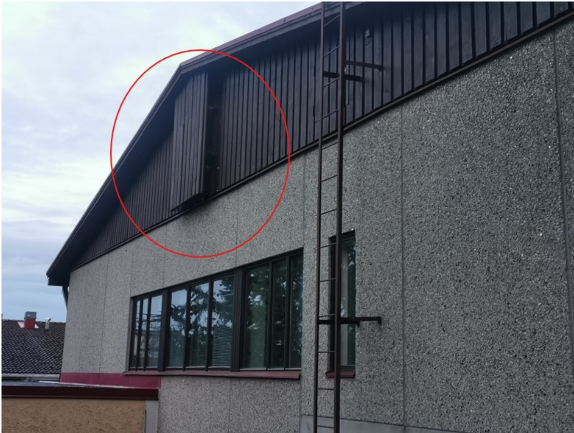
Kuva 8. Tervapääskyjen pesintöjä seinään tehdyssä rakenteessa.
